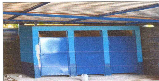
Foto 6: Puertas en mal estado.
